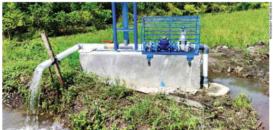
Sumur artesis di Winongan, Kabupaten Pasuruan. Sumur ini dilengkapi keran agar penggunaan air lebih efisien.
